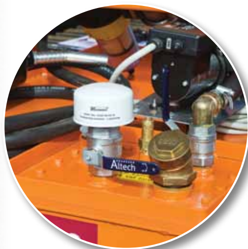
Partikkelfilter 3 mikron på inntaksluft
